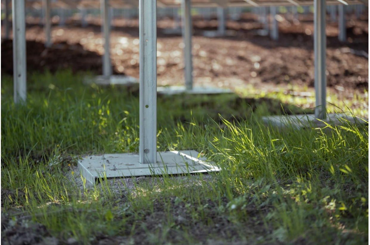
Figur 16-Om marken har dålig bärighet kan stålprofilerna behöva förstärkas med plattor vilket syns på bilden ovan. Om plattorna grävs ner under mark ökar motståndskraften mot vindlyft.
