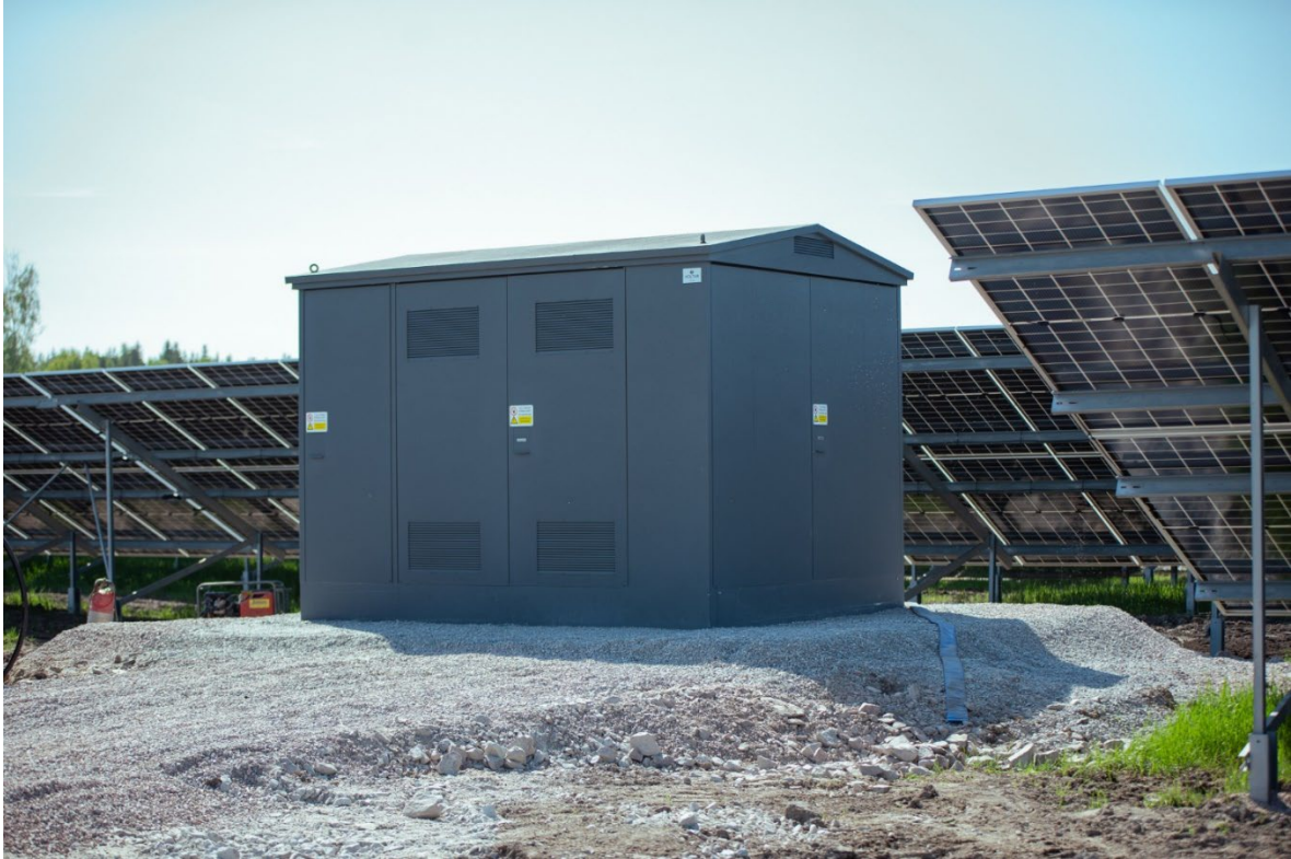
Figur 18-Exempel på mindre transformatorenhet som placeras ut i parken. Helios Nordic Energy AB:s solcellspark Kungsåra.
