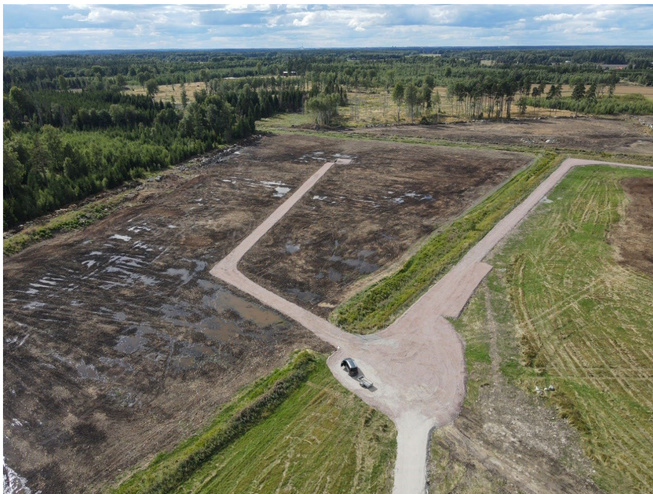
Figur 35-Solcellspark under konstruktion. Till höger i bild har marken brukats som jordbruksmark och till vänster som skogsmark. Byggvägar fram till transformator har här anlagts.
